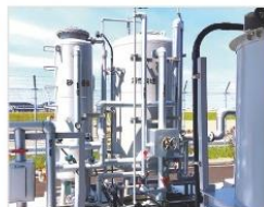
ろ過設備/活性炭設備
