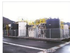
凝集沈殿設備
