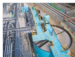
加圧浮上設備
