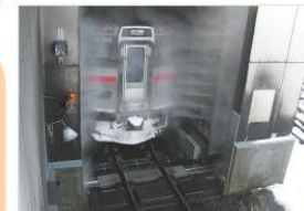
鉄道車体洗浄設備
